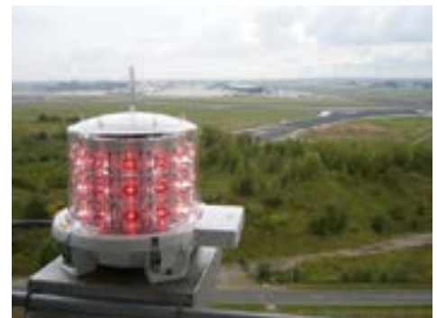
Bild 9: Sicherheits-LED-Beleuchtung auf einem Mast
