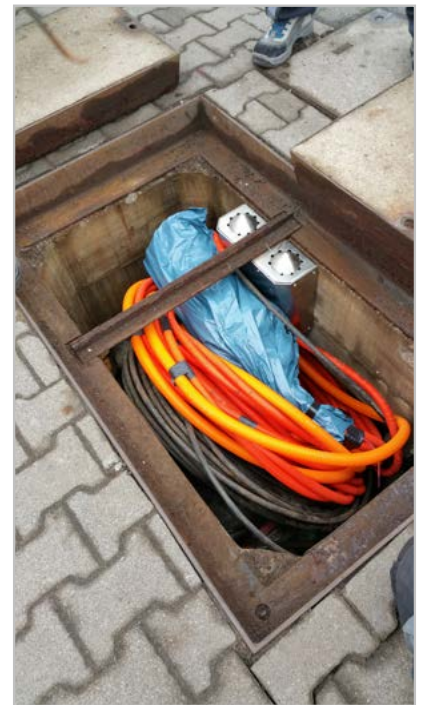
Abbildung 3: Glasfaserschachtsensoren (© Eolis Media Co/GridCop®)
